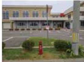
新しい「消火栓」(夏期)
