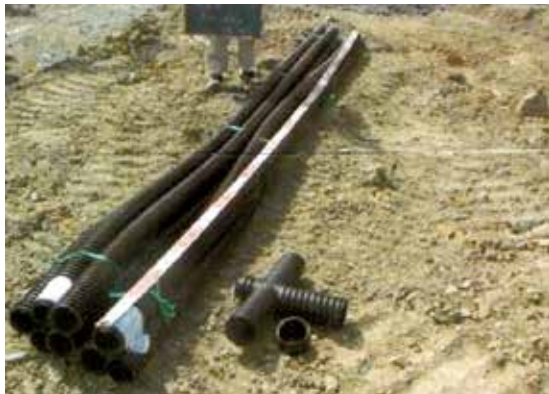
暗きょはい水管
