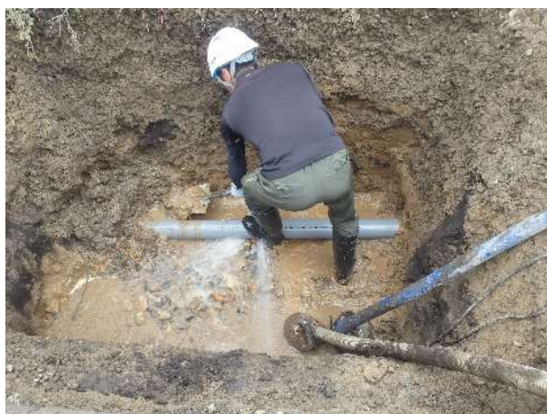
硬質塩化ビニル管漏水状況
