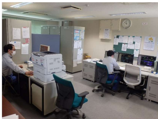
湯沢管理事務所 (中央監視システム)
