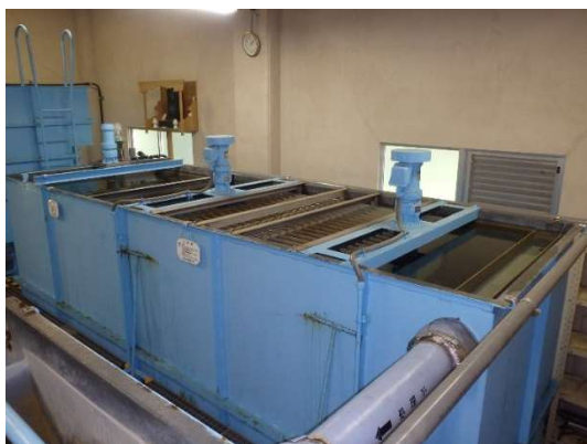
高松浄水場 急速ろ過施設
