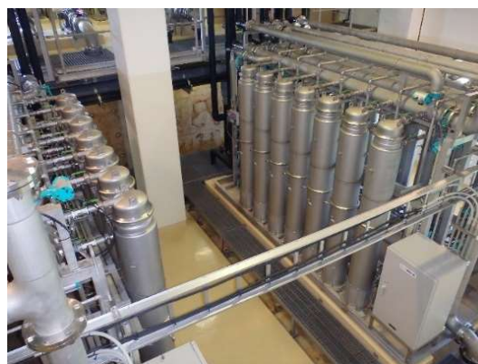
岩崎浄水場 膜ろ過施設
