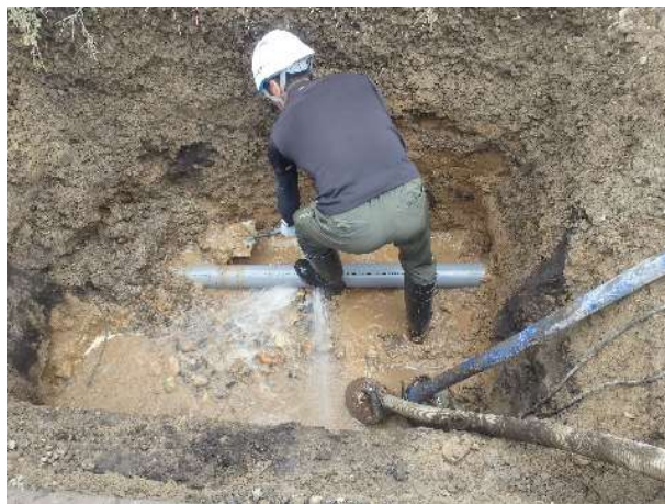
硬質塩化ビニル管漏水状況
