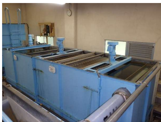
高松浄水場 急速ろ過施設
