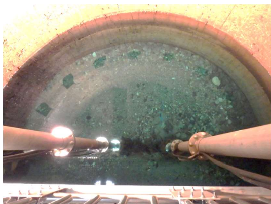
湯沢上水道第1水源
