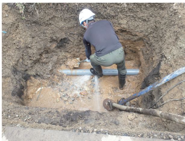
硬質塩化ビニル管漏水状況
