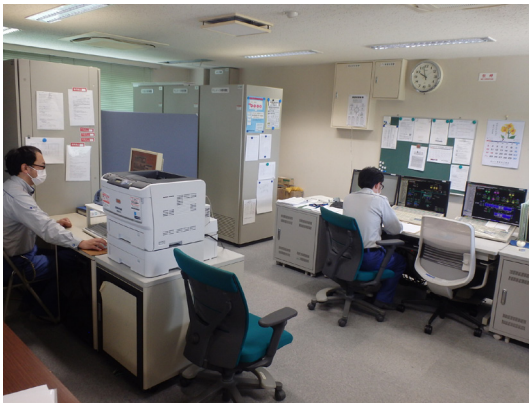
湯沢管理事務所 (中央監視システム)
