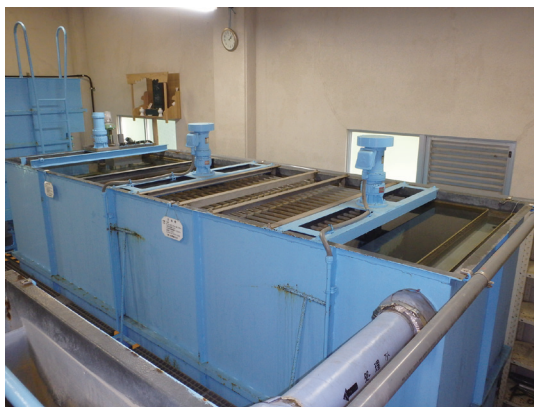
高松浄水場 急速ろ過施設
