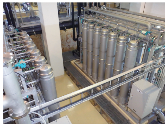
岩崎浄水場 膜ろ過施設
