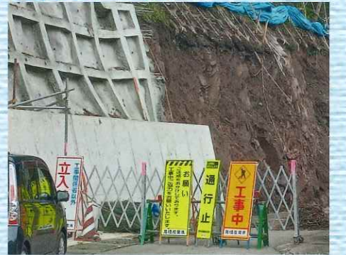
故大関衛県議と共に要望活動した急傾斜地域工事の工事が更に進んでいます。
