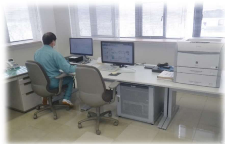
湯沢浄化センター内 中央監視システム
