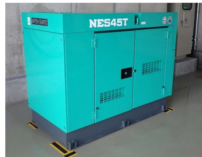
稲川浄化センター 可搬式発電機
