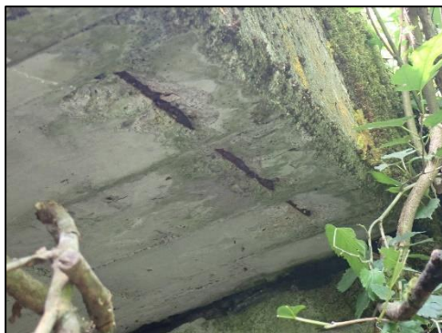
・床版の鉄筋露出
