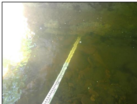
・橋台の洗堀
