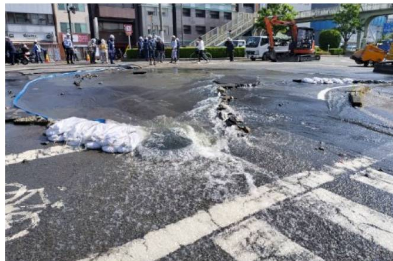
京都市国道1号で発生した漏水事故 (4/30)
