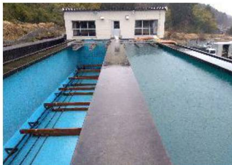
浄水場の被害（珠洲市）
