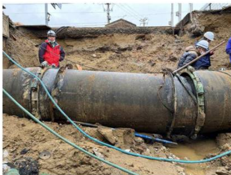
送水管の被害（七尾市）
