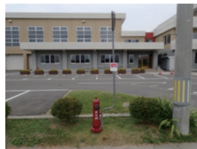
しょうかせん 消火栓
