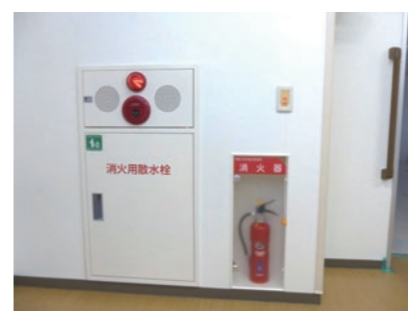
しょうかせん 消火栓
