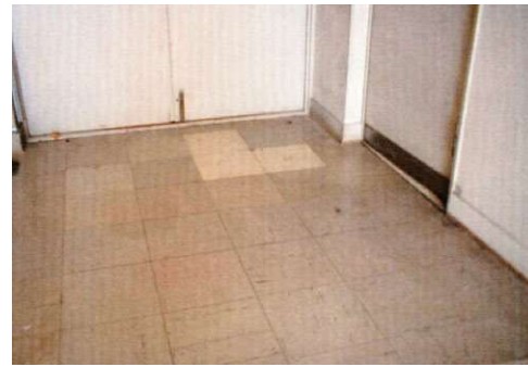
図 3. 107 石綿含有ビニール床タイル
