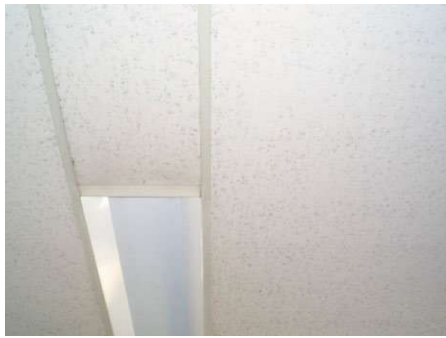
図 3. 106 石綿含有ロックウール吸音天井板
