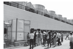
▲地熱発電のシンボルの存在 [冷却塔]
