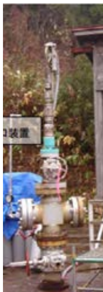
掘削後の温度・圧力モニタリングを行っている井戸の例
