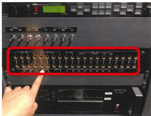
←110号パッチ盤 設置状況
