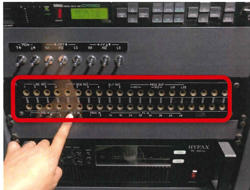
←110号パッチ盤 設置状況
