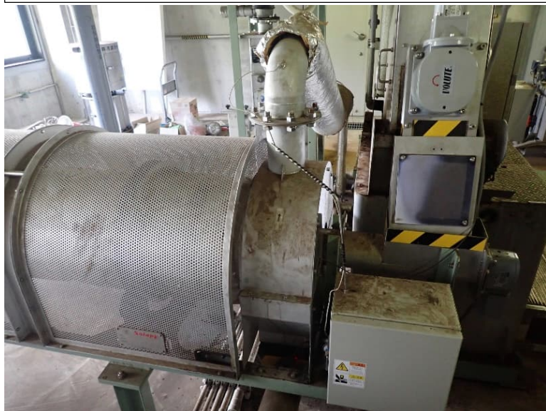
小安浄化センター 汚泥乾燥機
