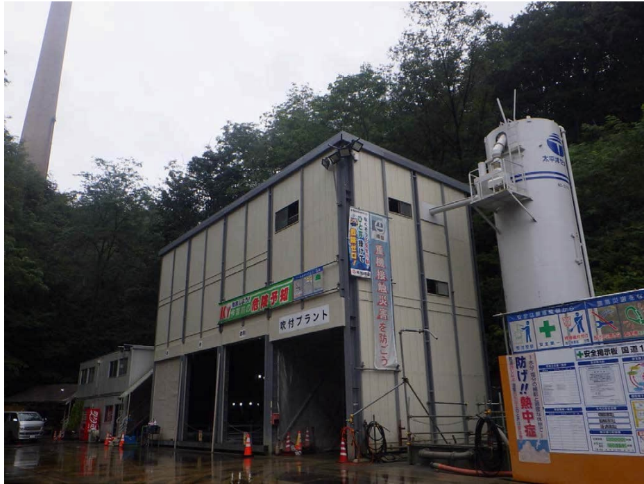
バッチャープラント (吹付コンクリート製造プラント)
